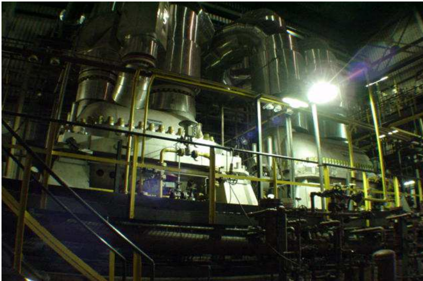
Compressore centrifugo gas siderurgici - CET3
