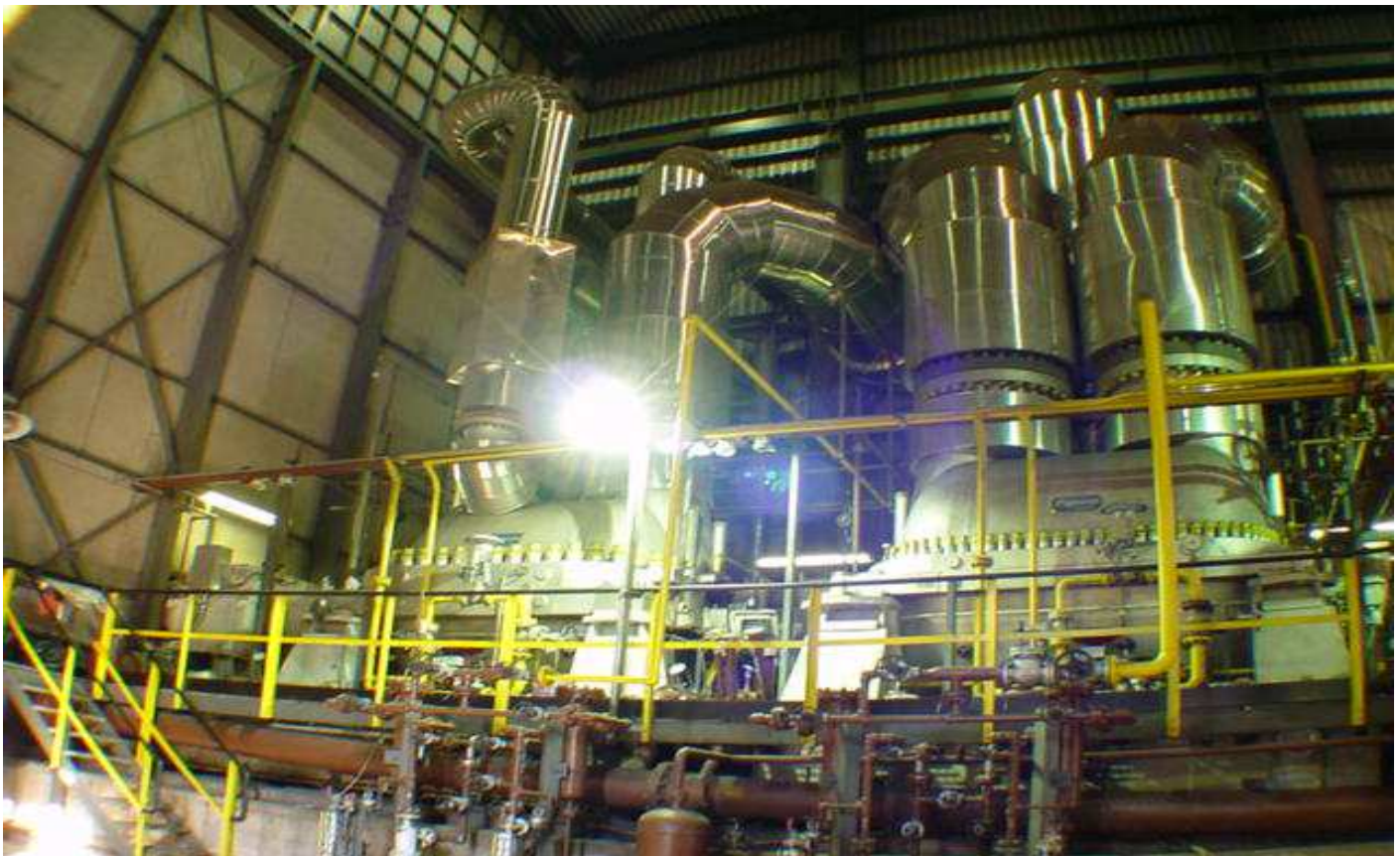
Compressore centrifugo gas siderurgici - CET3
